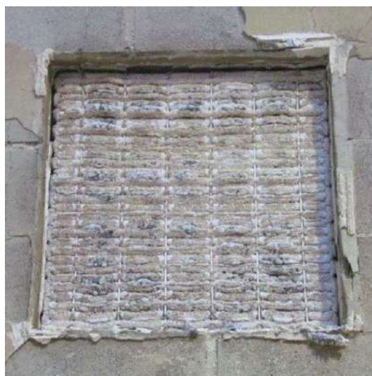
Face exposée après l'essai.
