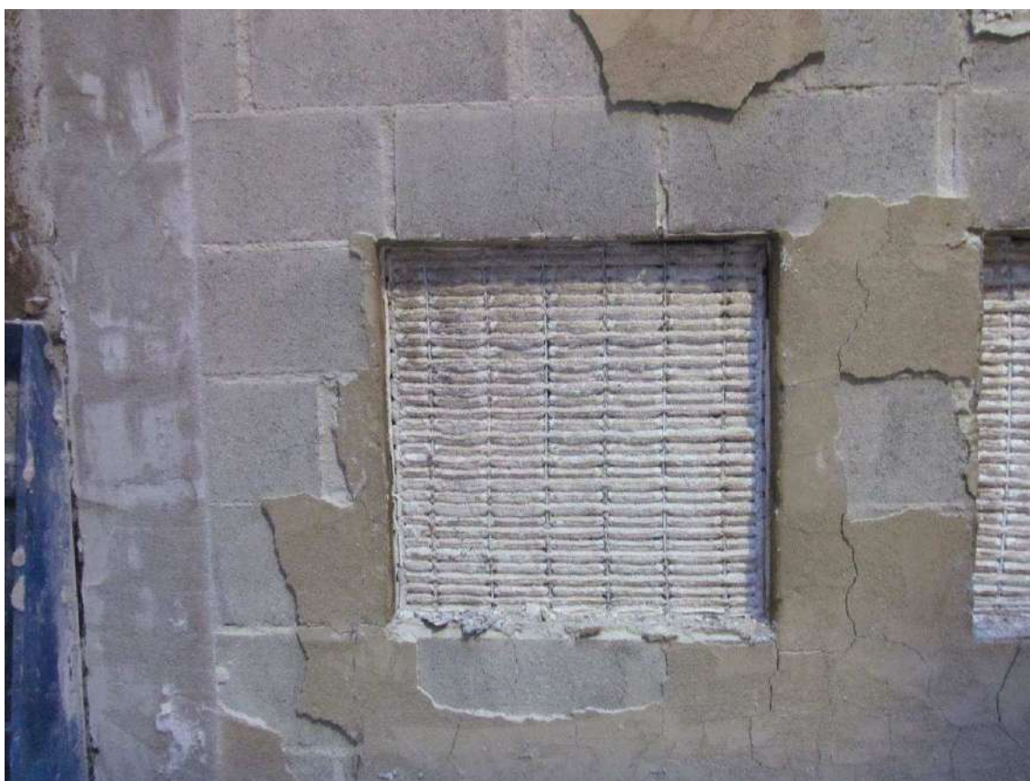
Face exposée après l'essai.
